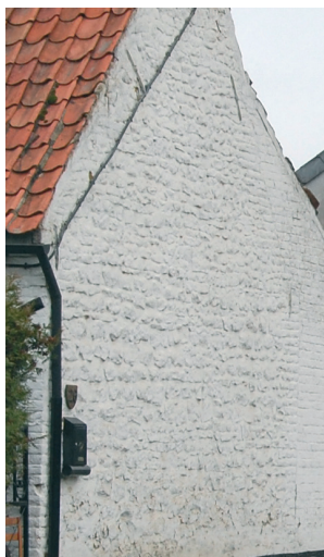
Le badigeon de teinte blanche appliqué sur les maçonneries en brique comme en pierre : quelques témoins persistent encore.
