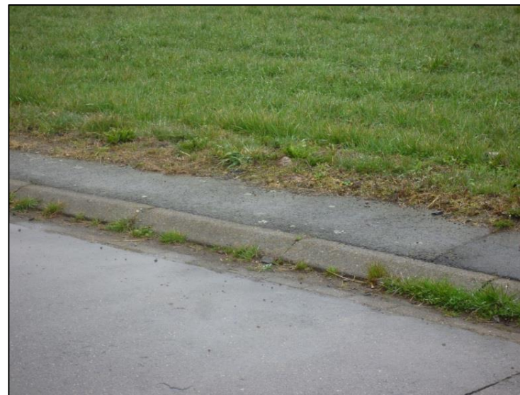
Figure 39: Photographie d'un trottoir peu praticable à Péruwelz
