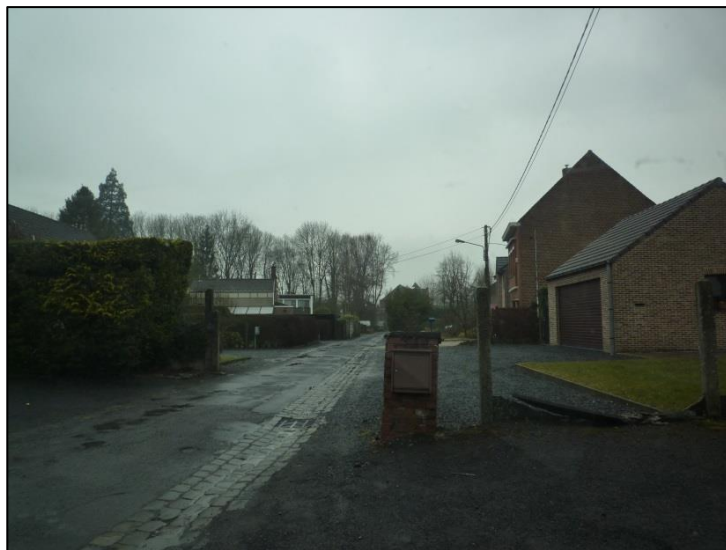
Figure 37: Photographie d'une rue au revêtement endommagé à Péruwelz
