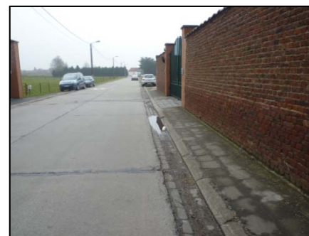
Figure 254 : Photographie, trottoir extrêmement étroit à ( \pm 90cm) rue de Beaumont à Bury
