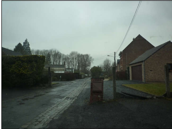
Figure 301: Photographie d'une rue au revêtement endommagé à Péruwelz
